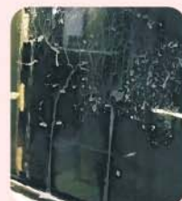
水分が残った状態
